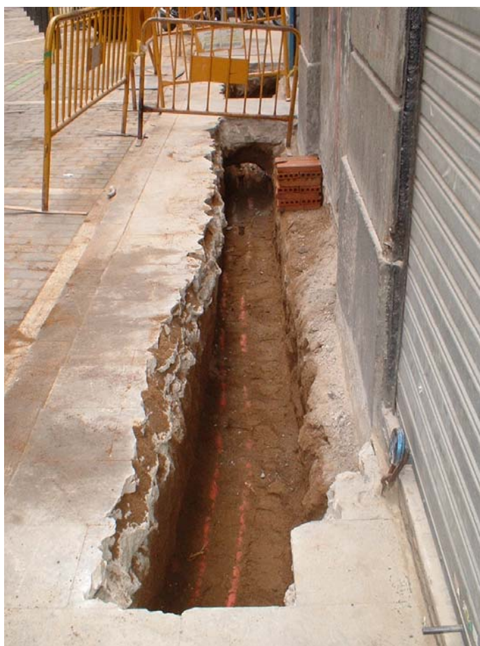
Fotografia 18: Tram parcial de la Rasa 400 amb el servei elèctric anterior.
